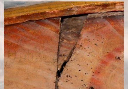
Figura 3: Detalle de un fragmento en riesgo de caída. Fotografía de la autora. (2020)
